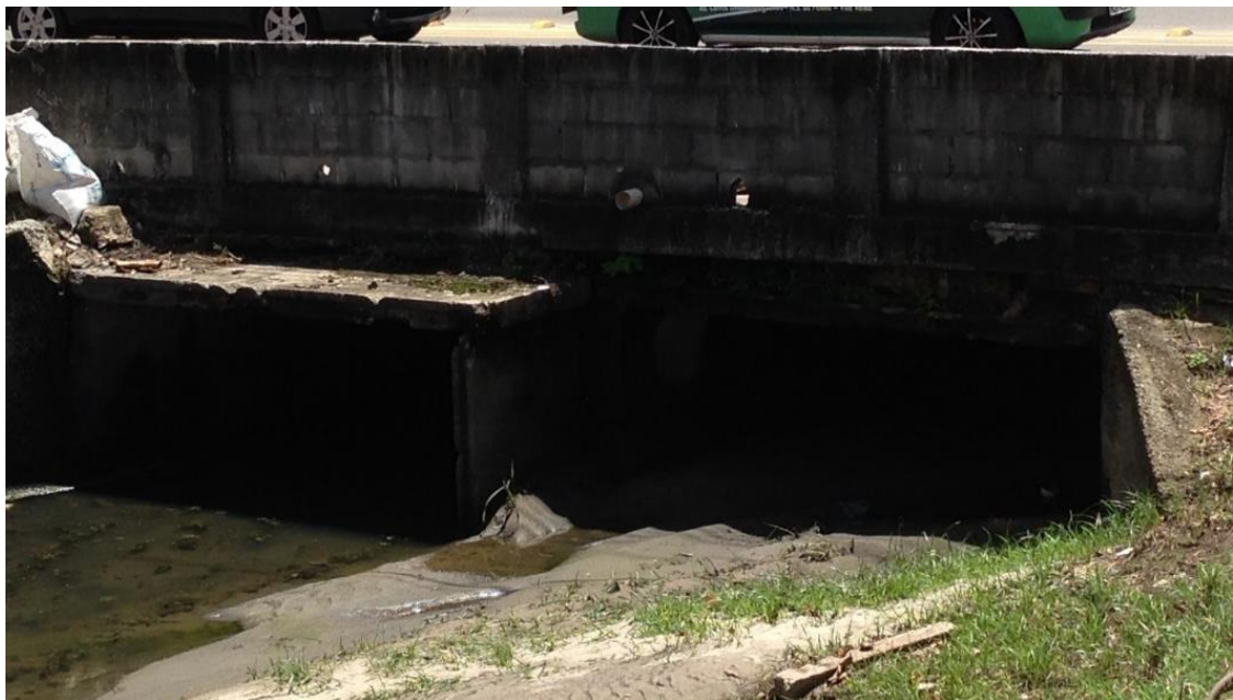
Figura 14 – Bueiro duplo celular em concreto sob Av. Leila Diniz
