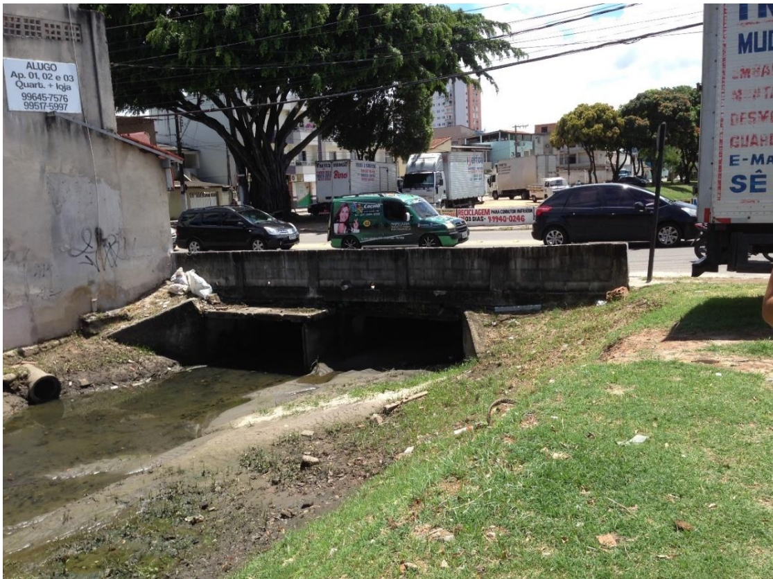
Figura 13 – Bueiro duplo celular em concreto sob Av. Leila Diniz
