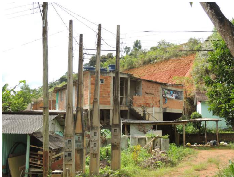
Foto 14 – Talude de corte e avanço da ocupação.
