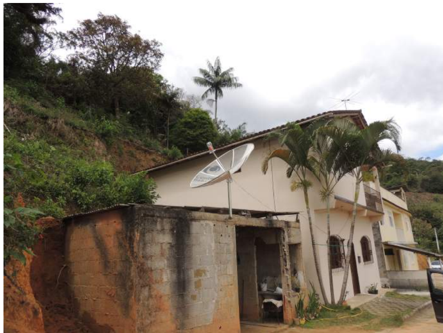
Foto 11 – Talude de corte e domicílios que compõem o setor de risco.
