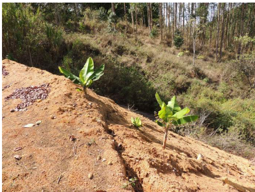
Foto 39 – Sinais de instabilidade a montante do setor de risco. Trincas no aterro.
