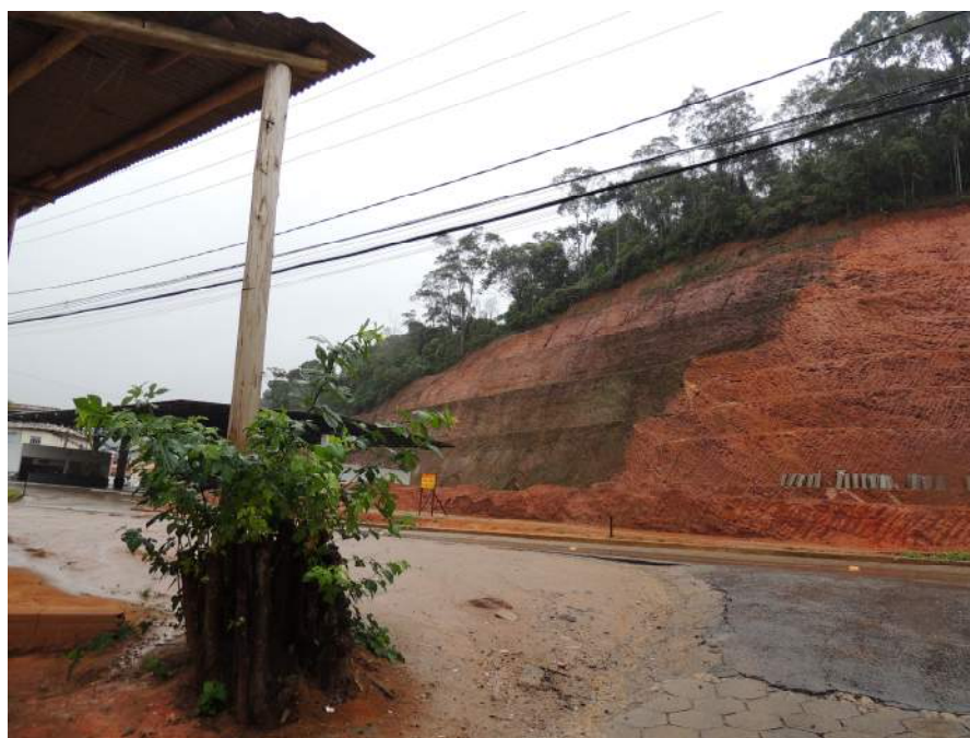
Foto 21 – Encosta próxima a rodoviária sendo retalhada.
