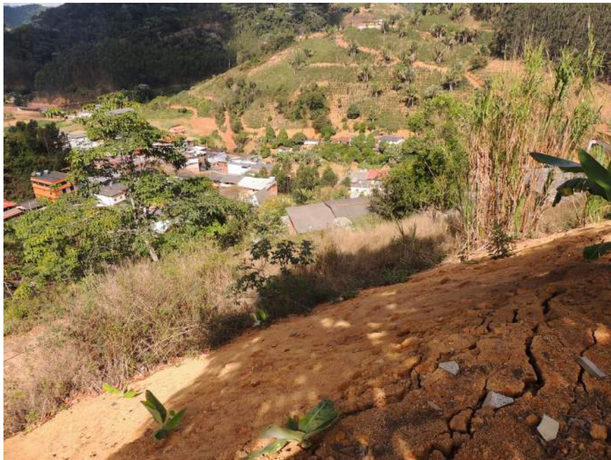
Foto 40 – Trincas no aterro a montante do setor de risco.
