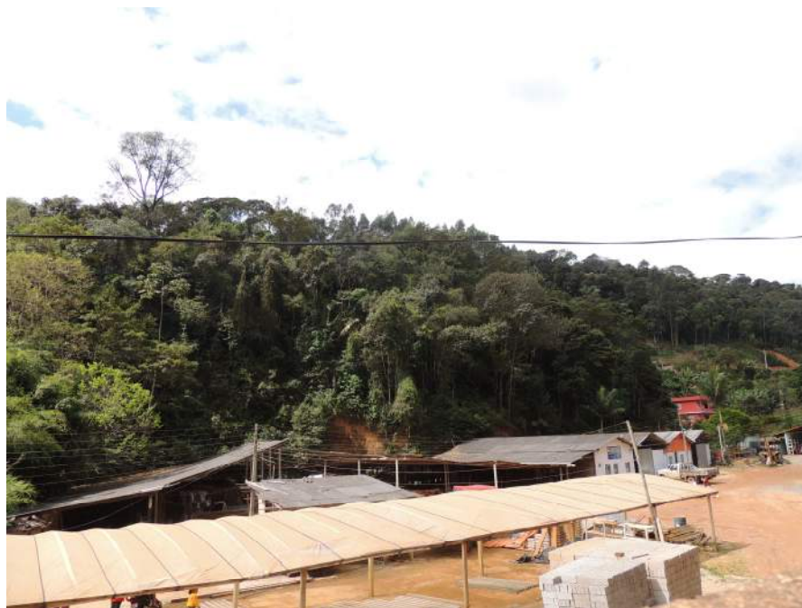
Foto 20 – Indícios de instabilidade ao longo da encosta com edificações na base.
