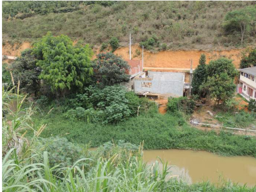
Foto 3 – Domicílios sendo construídos nas margens do canal em área suscetível a inundações.
