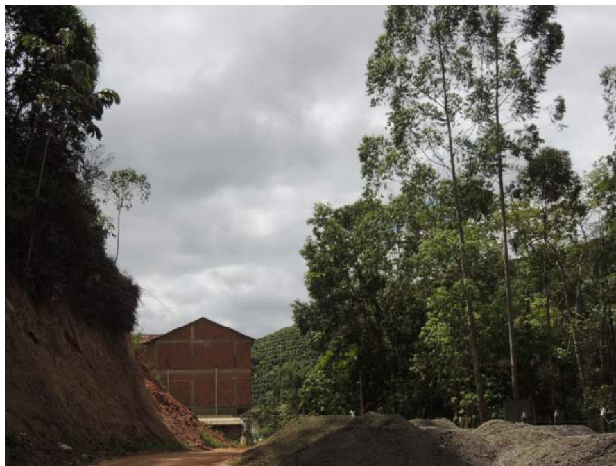
Foto 7 – Talude de corte instável e domicílios na base.
