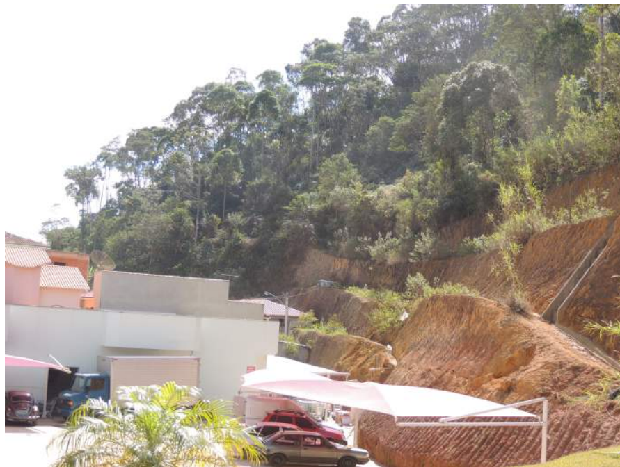
Foto 27 – Trecho complementar do setor de risco.
