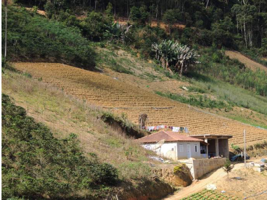
Foto 48 – Talude de corte não estabilizado.
