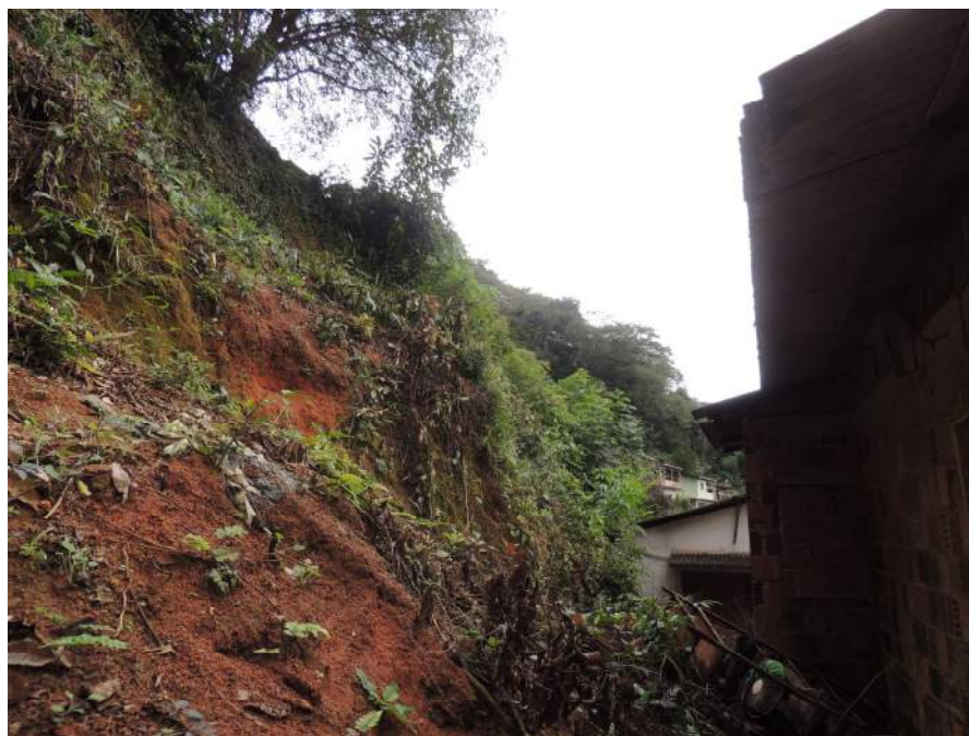
Foto 39 Indícios de instabilidade a montante do domicílio com histórico de movimentos de massa.
