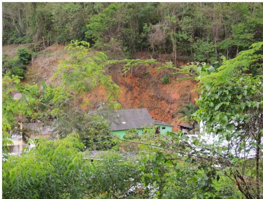
Foto 29 - Indícios de instabilidade a montante do domicílio. Talude de corte com altura superior a 7,0m.
