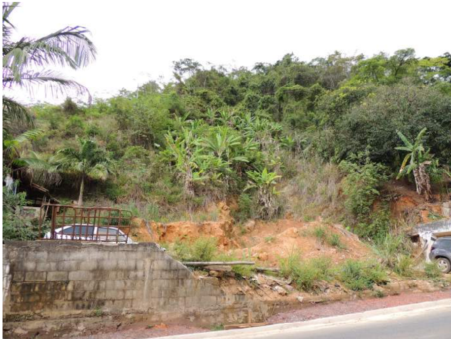
Foto 19 - Trecho instável da encosta com indícios de movimentos de massa.
