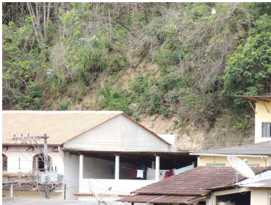
Foto 11 – Vista aproximada dos fundos de um dos domicílios. Talude vertical em solo residual sobre rocha sã.
