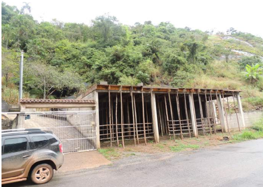
Foto 16 – Domicílios em construção em trecho instável da encosta.
