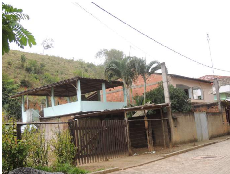
Foto 37 – Vista parcial do setor de risco. Domicílios construídos ao longo de toda a base da encosta.
