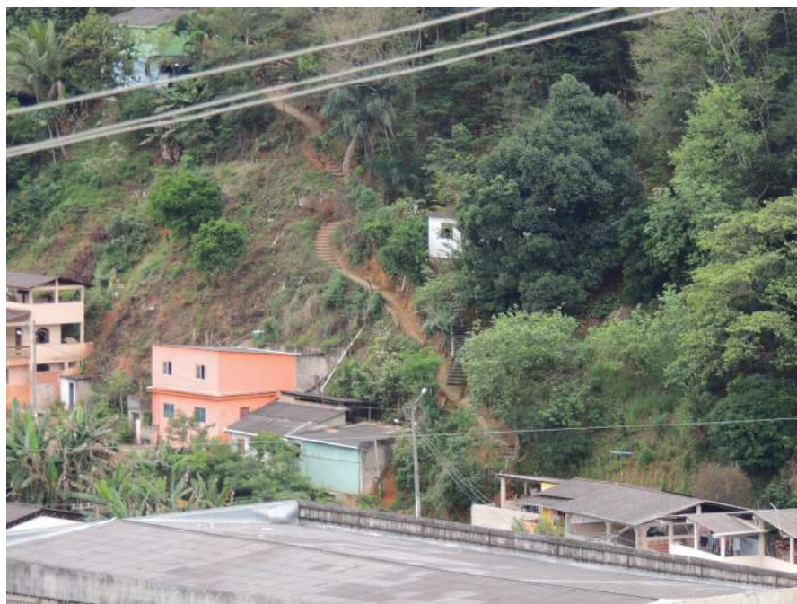
Foto 24 – Trecho com indícios de movimentação do terreno. Acesso de pedestre a meia encosta precário.
