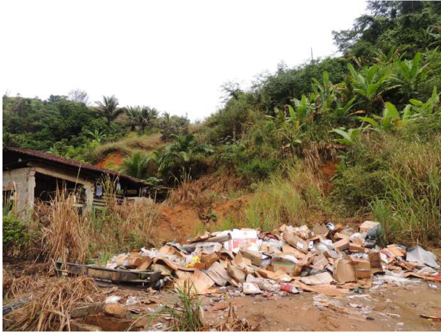
Foto 18 – Trecho instável da encosta com indícios de movimentos de massa.
