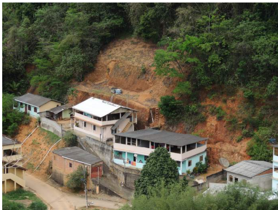
Foto 6 - Talude de corte com geometrias inadequadas e indícios de movimentos de massa.
