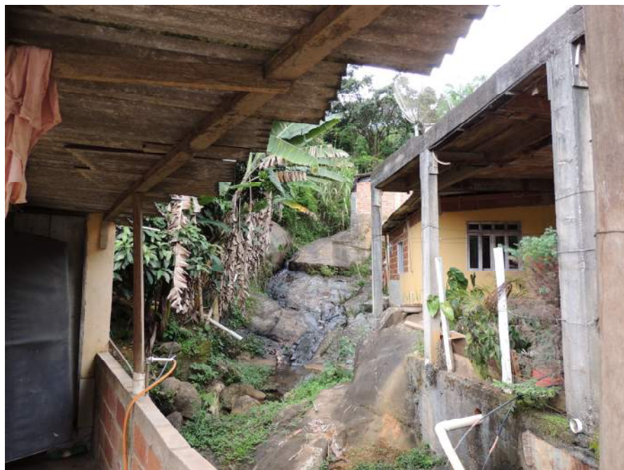
Foto 22 – Notar avanço da ocupação sobre a linha de drenagem.
