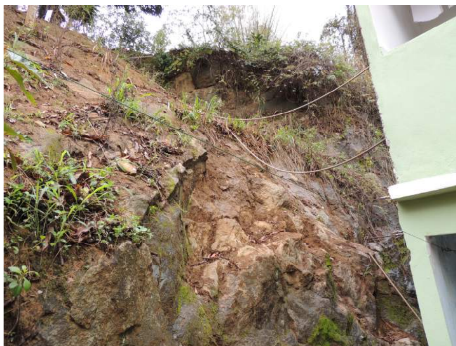
Foto 33 – Maciço rochoso fraturado com rolamento de blocos e lascas rochosas.
