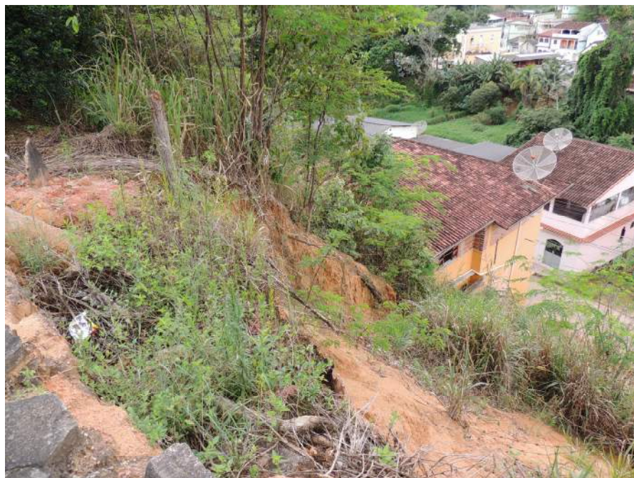
Foto 4 – Vista do talude instável e ocupação da base da encosta.
