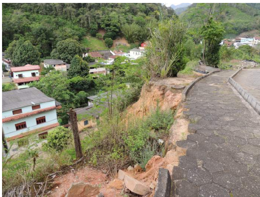
Foto 5 – Detalhe para o trecho onde já ocorreram movimentos de massa.
