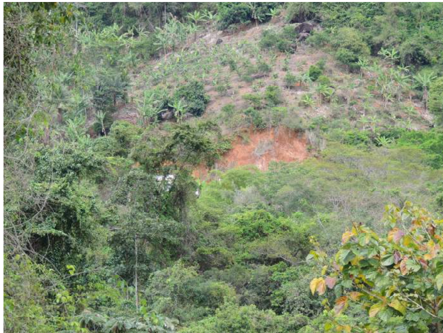
Foto 12 – Ocupação fora da sede. Domicílio construído na base de uma encosta com geração de um talude vertical com altura superior a 10,0m. Notar blocos rochosos no topo da encosta.
