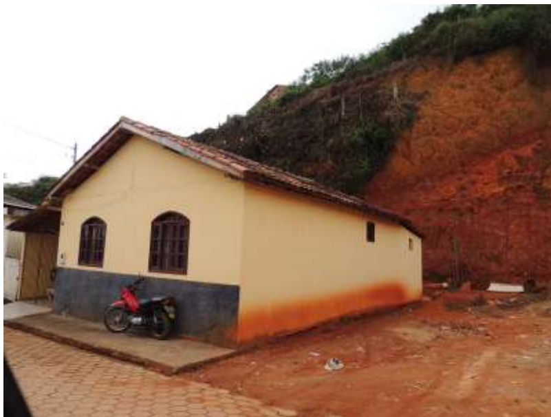
Foto 6 – Detalhe para o afastamento mínimo entre os domicílios e a face do talude de corte.
