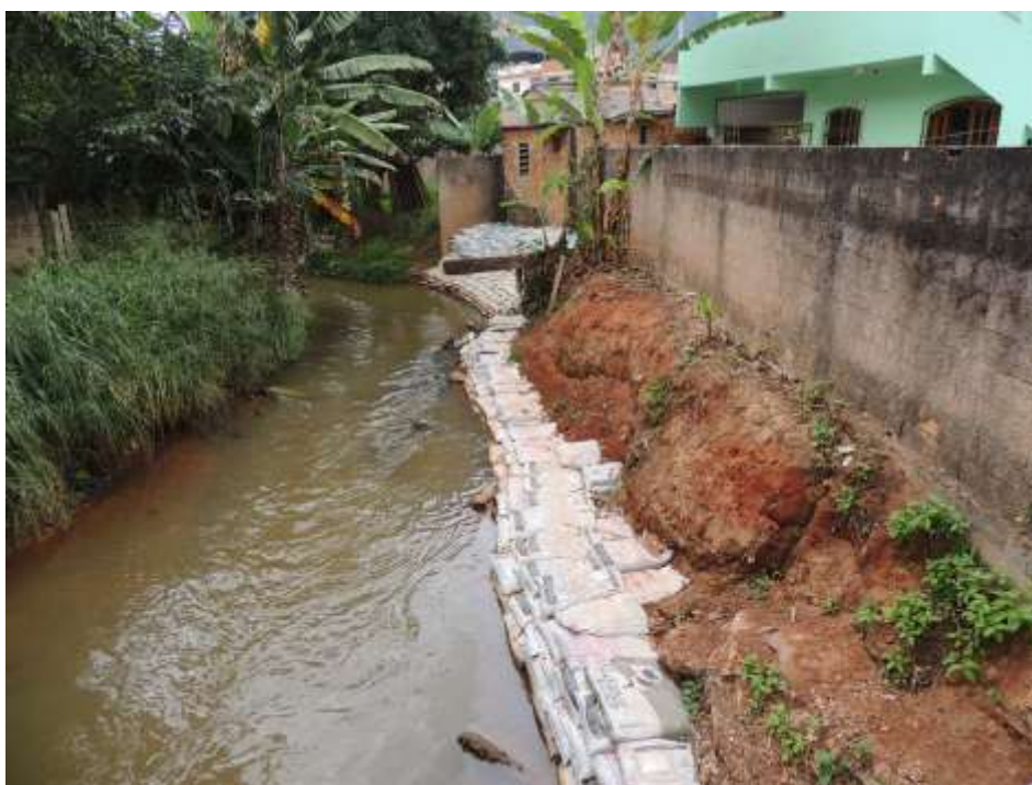
Foto 1 – Domicílio de médio e baixo padrões construtivos construídos adjacentes e sobre o canal e trecho naturalmente suscetível a solapamentos.
