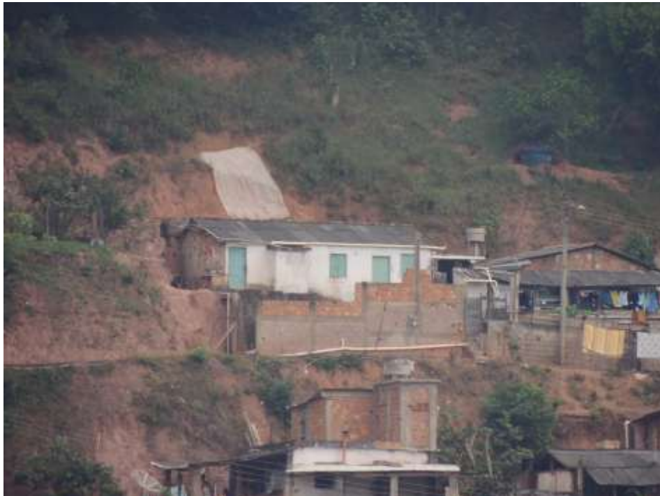
Foto 13 – Vista aproximada com detalhe para o padrão construtivo, formas de ocupação e taludes instáveis.
